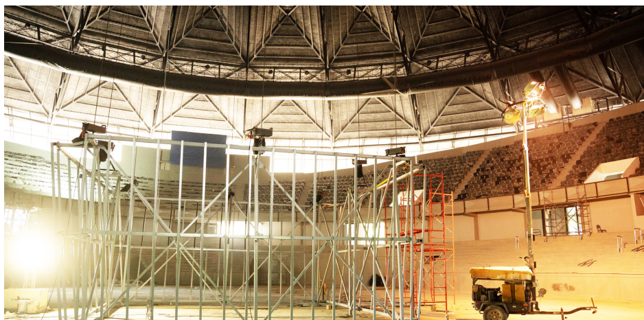
Aspecto de los trabajos que se realizan en el Palacio de los Deportes Virgilio Travieso Soto.
